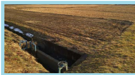
8 境野大堰水路の流末ゲート ここから田んぼに配水される。気持ちのいい水田の風景。
