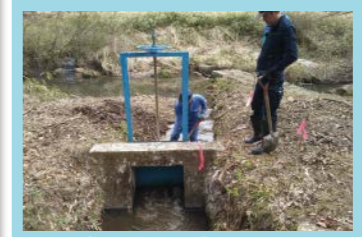
4 杉沢川取水口 境野大堰水路の始まりのゲートです。
